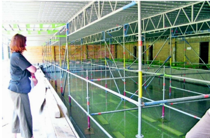
Baustelle im Schwimmbecken Wehrda. Bäderdezernentin Dr. Kerstin Weinbach (SPD) schaute sich das Bad an. Fotos: Anna Ntemiris
